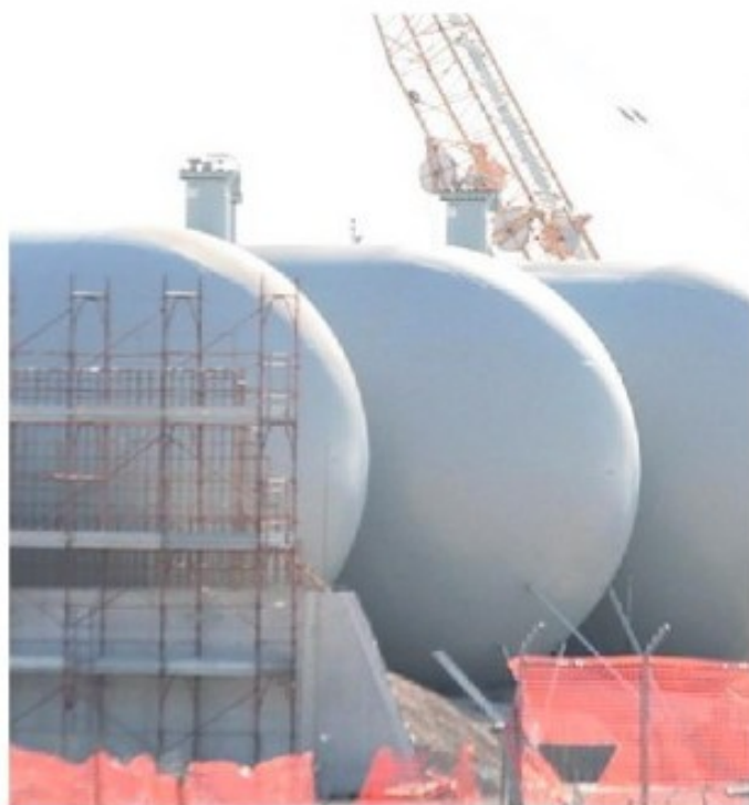
I "bomboloni" installati a Val da Rio per l'impianto Gpl poi bloccato
